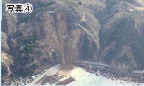
国道249号法面崩落
